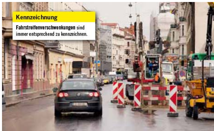
Abbildung 4: Korrekte Kennzeichnung einer Baustelle in der Innenstadt – Fahrstreifenverschwenkungen werden mit Gefahrenzeichen entsprechend gekennzeichnet.
